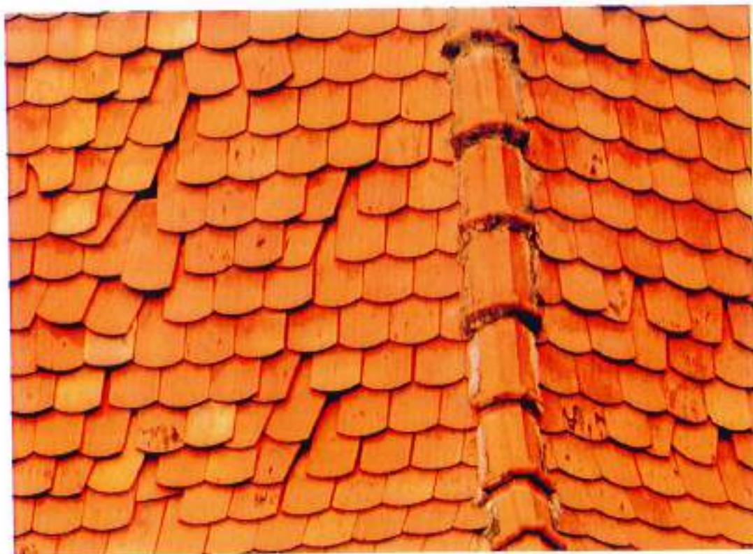
Fig.5.- Detaliu cu țigle deplasate și coame de producție industrială, ce ar fi indicat să fie înlocuite cu coame de formă istorică, adică de formă tronconică simplă.
