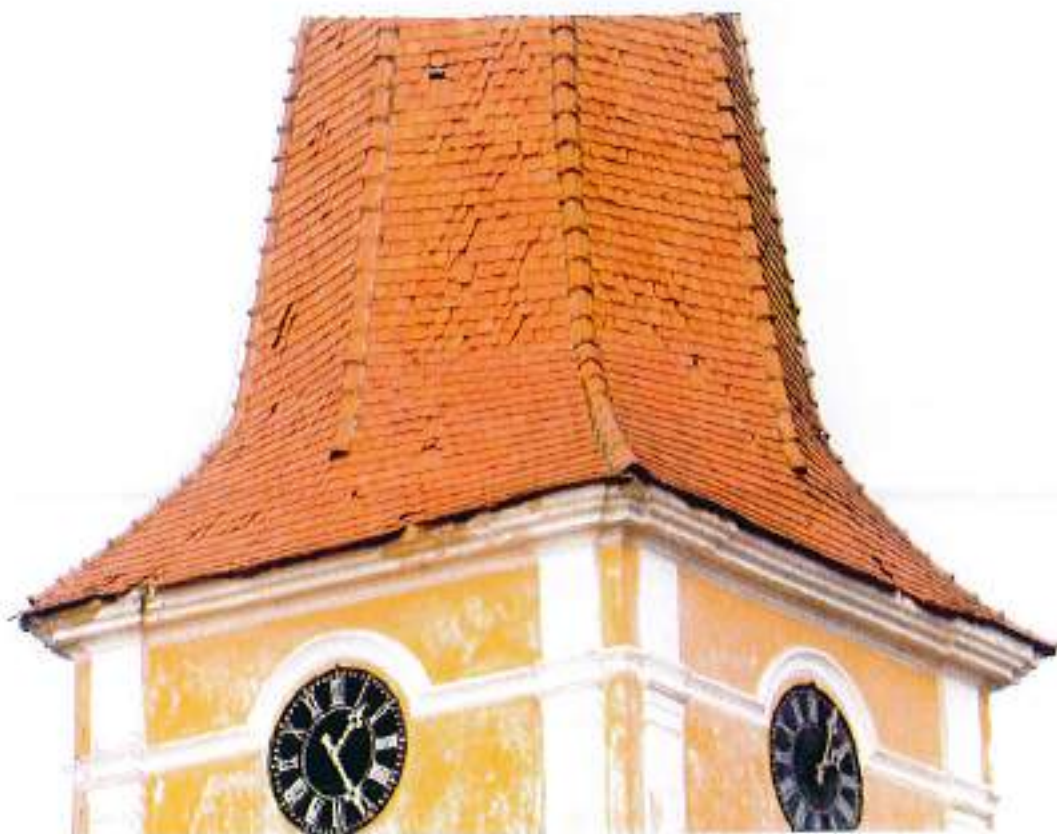
Fig. 4.- Vedere a părții superioare a turnului cu deficiențele menționate.
